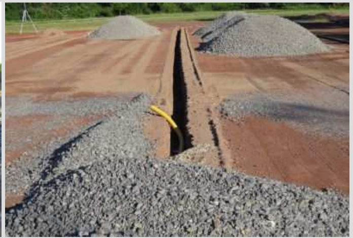
Eine vernünftige Drainage darf natürlich nicht fehlen
